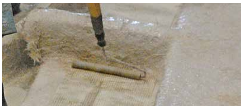
3 Se utilizan rodillos de compactación para cubrir toda la fibra con mezcla, eliminar aire atrapado y consolidar el material compuesto.
