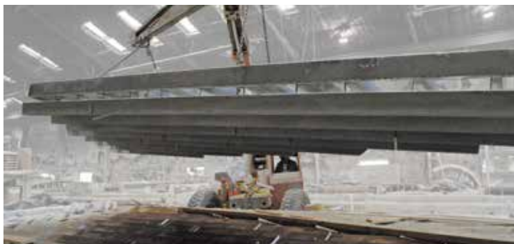
7 Se permite que los paneles fragüen por 12 horas antes de ser removidos del molde.
