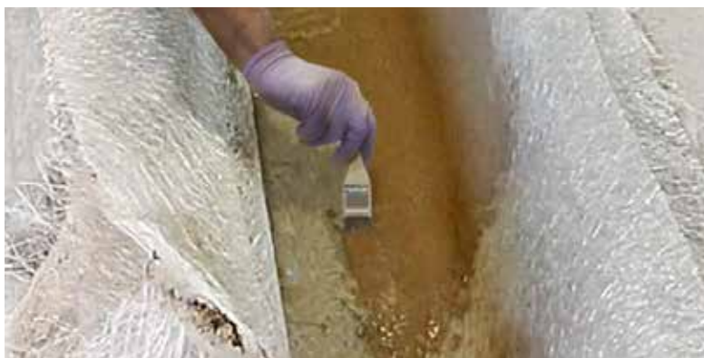
3 Se aplican capas alternando Forton® MG y fibra de vidrio tipo 'E' hasta llegar a la anchura deseada típicamente 10mm (3/8").
