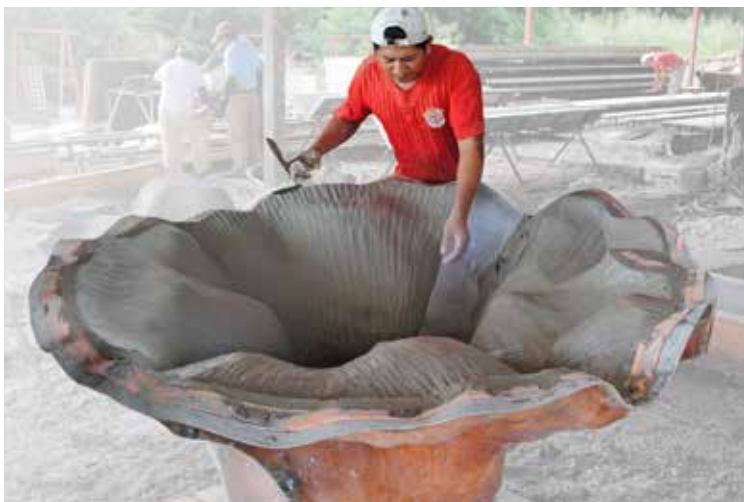
6 Se aplica una malla de fibra de vidrio y GRC adicional a mano para incorporar la unión.
